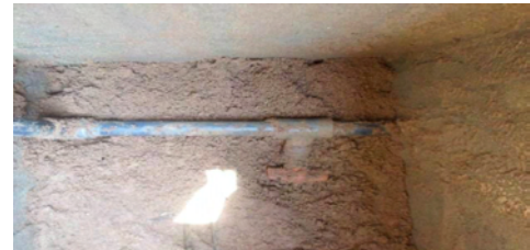
Photo 6. Canalisation du gaz et la vanne de purge de l'eau
